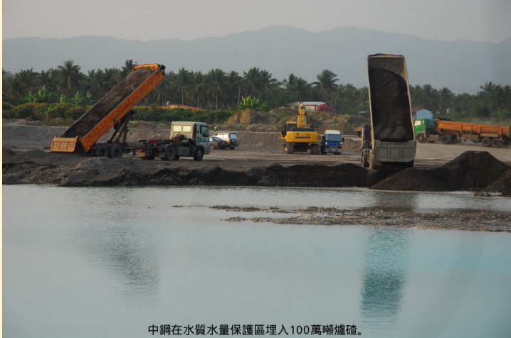
中鋼在水質水量保護區埋入100萬噸爐渣。
