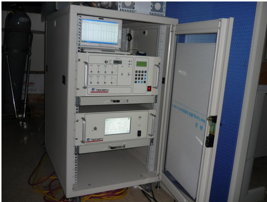
圖 5-6 Tekran 監測分析儀主機部份
