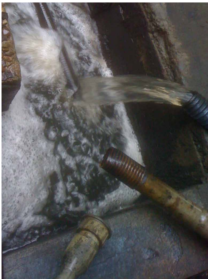
廢水沒有經過完善的處理，就直接排到廠內的雨水溝裡。
