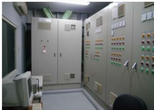
飛灰固化控制室
