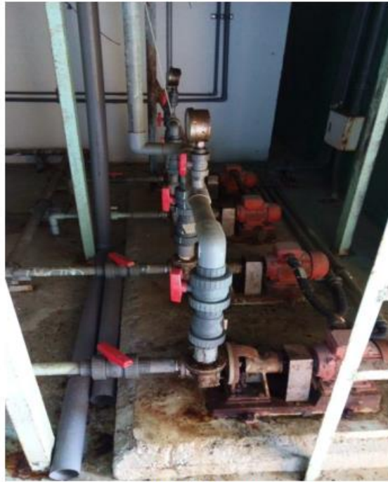
廢水廠輸送泵
