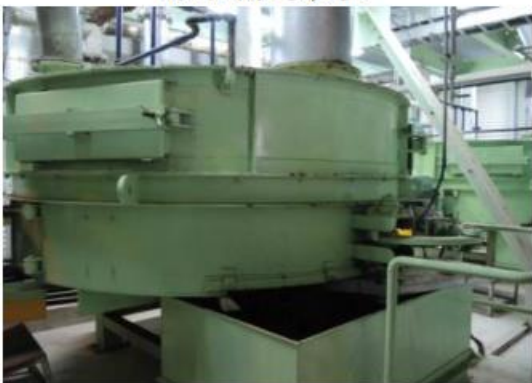
飛灰固化混鍊機
