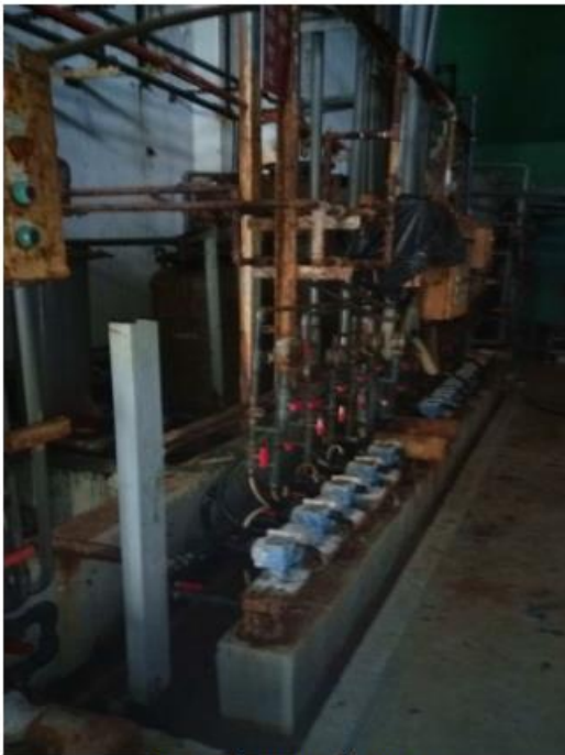
廢水處理加藥設施
