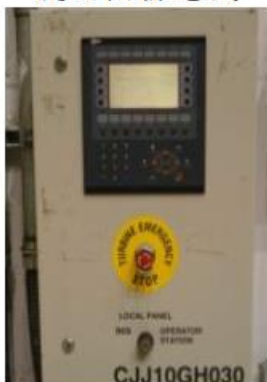
發電機啟動盤
