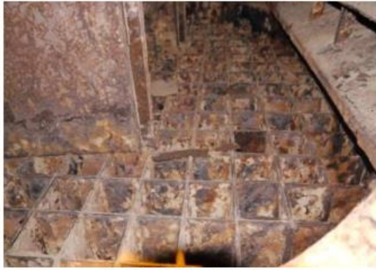
煙氣冷卻塔內部
