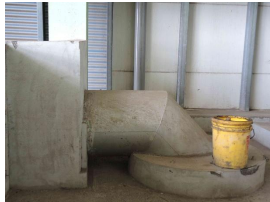
垃圾貯坑除臭設施
