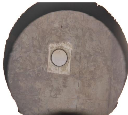
爐內耐火設施
