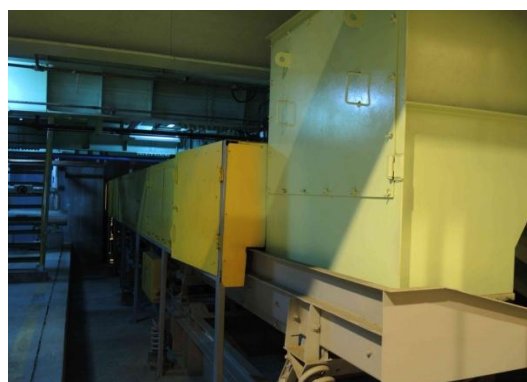
底渣排出裝置
