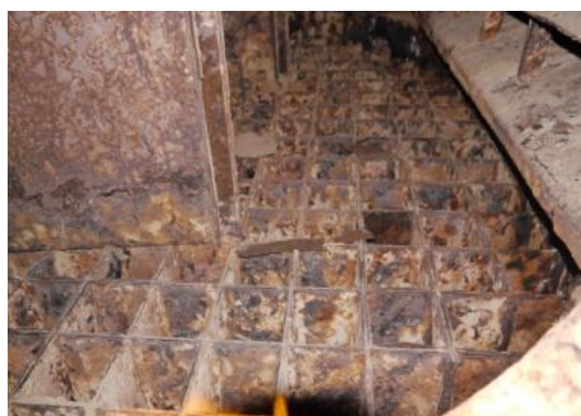
煙氣冷卻塔內部
