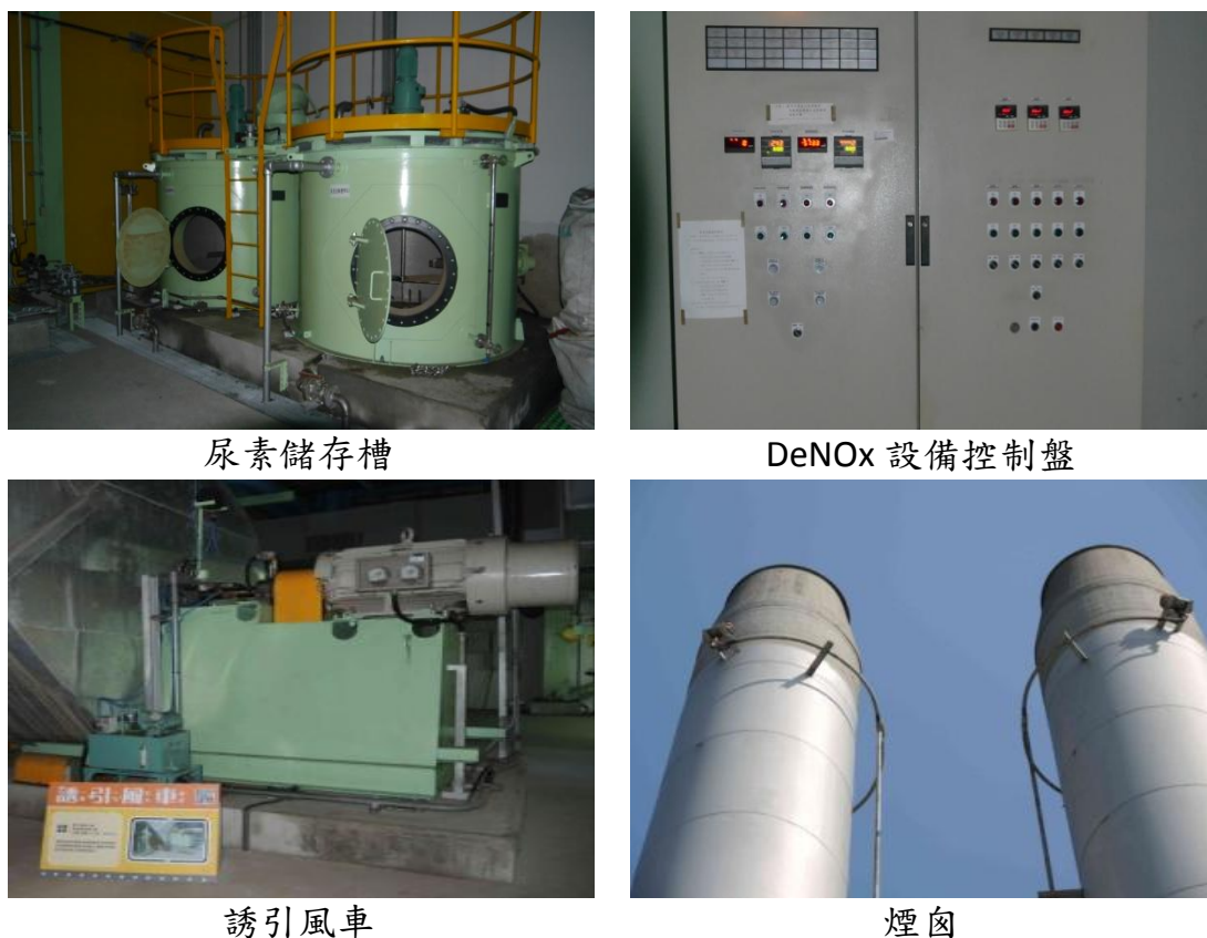
圖 4.2.2-5 廢氣淨化系統現勘照片(續)
