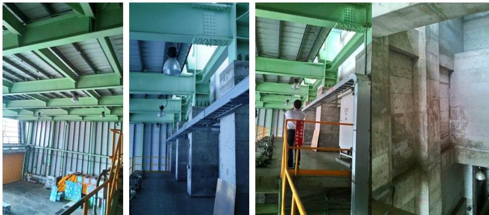
圖 4.3.1-2 臺東廠垃圾傾卸區結構現況照片
