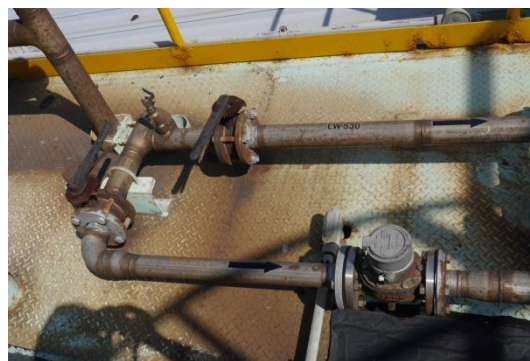
水輸送管線及閥件
