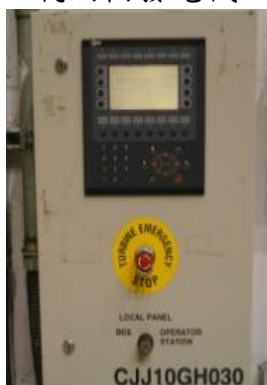
發電機啟動盤
