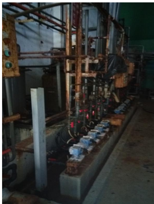
廢水處理加藥設施
