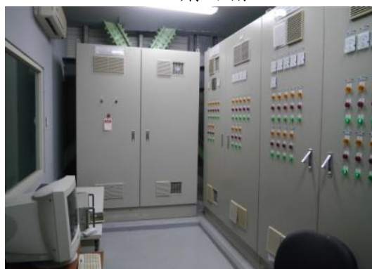
飛灰固化控制室
