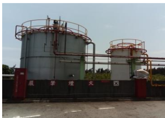
回收油室外儲槽
