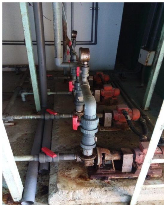
廢水廠輸送泵
